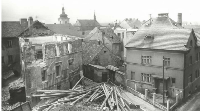
Bourání bloku domu U Fettrů (vpravo dosud stojící čp. 875, před ním dřevěné klády z krovů bouraného objektu), 1965.
